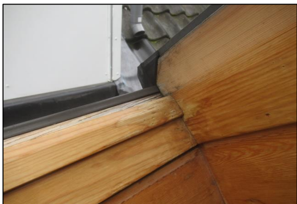
23. Onthechte laklaag dakvenster geconstateerd, esthetisch herstel, PM.
