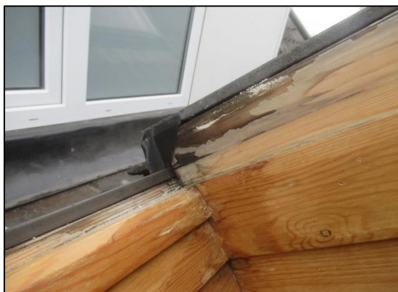
24. Onthechte laklaag dakvenster geconstateerd, esthetisch herstel, PM.
