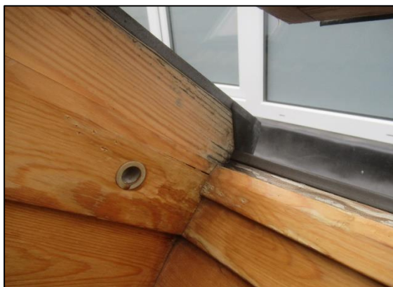
22. Onthechte laklaag dakvenster geconstateerd, esthetisch herstel, PM.
